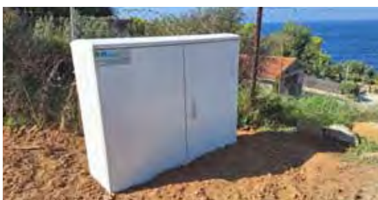
LVRSys installazione a terra
