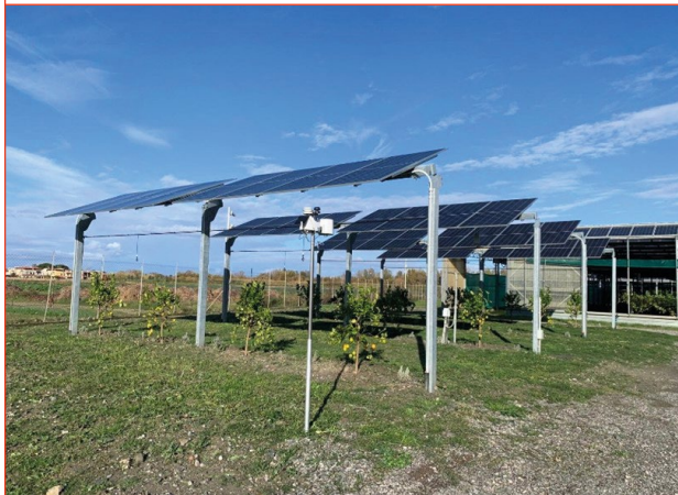
◆ FIGURA 1 Nuovo impianto agrivoltaico fisso realizzato presso il sito di Scalea (CS)
