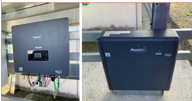
◆ FIGURA 3 Dettaglio inverter e batterie di accumulo
